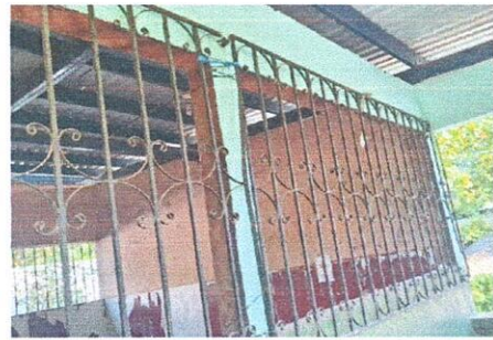
Foto 2: Se observan los balcones necesitan tener mantenimiento
