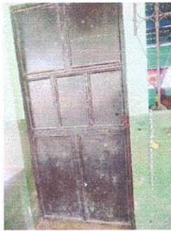
Foto 3: Se observa que las puertas están deterioradas, necesitan mantenimiento.
