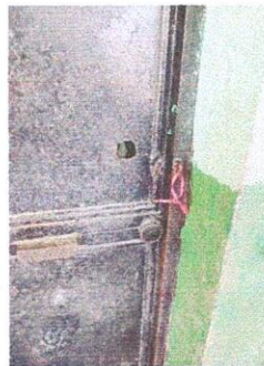
Foto 4: Se observa que las chapas se encuentran dañadas, deben ser cambiadas.
