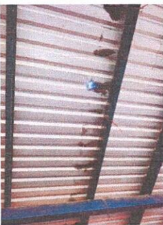
Foto 5: Se observa que las laminas se encuentran dañadas
