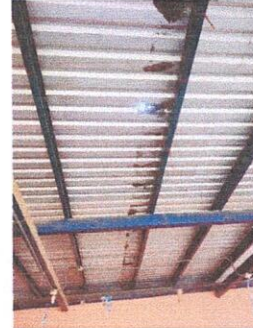
Foto 6: Se observa que la estructura del techo necesita ser sustituida.
