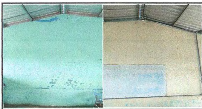
Foto 11: Se observa la necesidad de reparacion y sellado de grietas.
