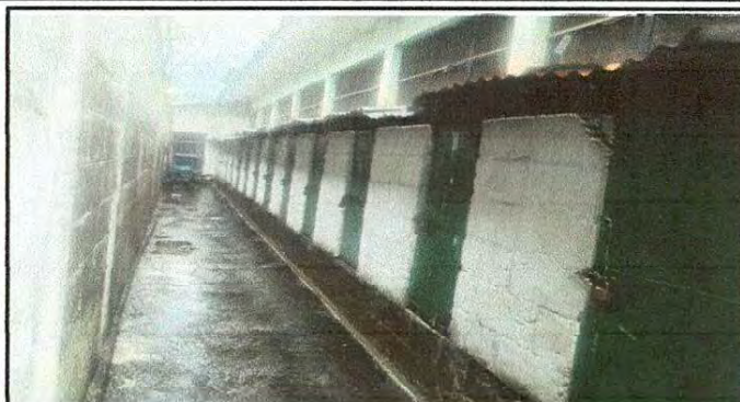
Foto 7: Se observa que la lámina galvanizada, se encuentra en mal estado.
