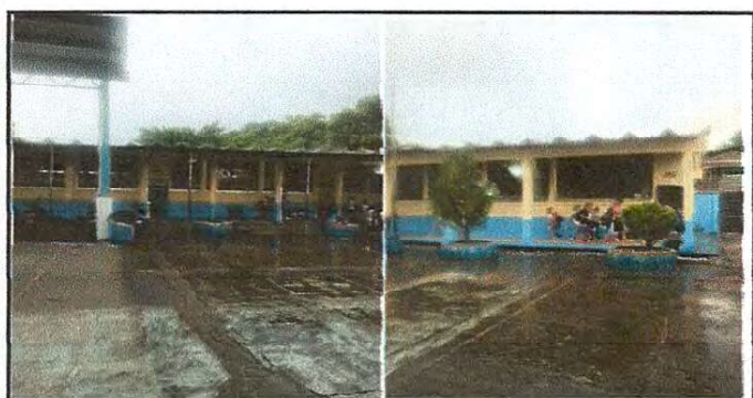
Foto 5: Se observa la necesidad de canales de metal.
