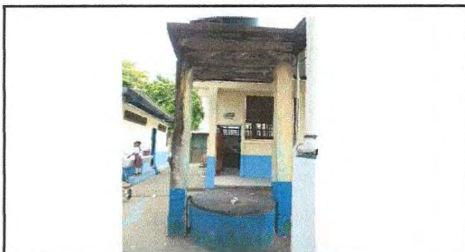
Foto 10: Se observa la necesidad de sustitución de pintura.
