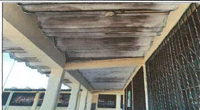
Foto 1: Se observa que la lámina duralita, se encuentra en mal estado.
