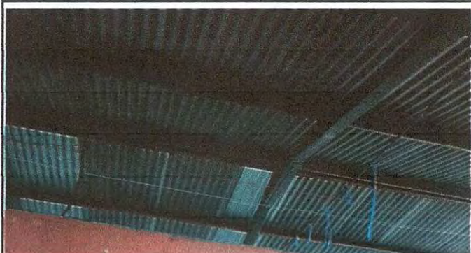
Foto 13: Se observa la necesidad de mantenimiento de estructura de metal.
