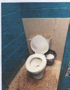
Foto 9: Se observan inodoros con faltante de piezas y mal funcionamiento
