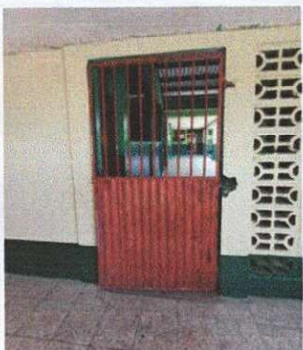
Foto 1: Se observa puerta en mal estado
