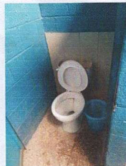
Foto 8: se observa azulejo incompleto en baños
