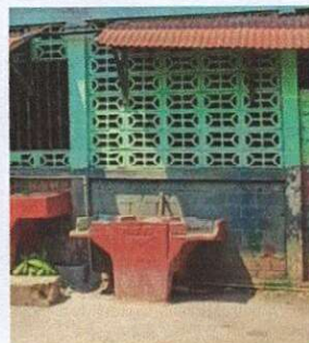
Foto 4: Se observa pila en mal estado
