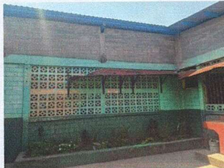
Foto 2: Se observan laminas en mal estado
