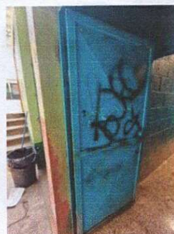
Foto 10: se observan puertas en mal estado superficial
