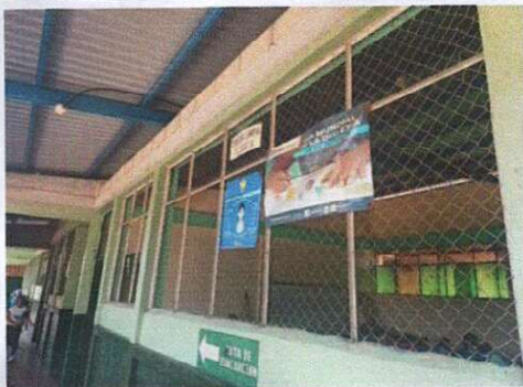
Foto 7: Se observa falta de balcones en aulas
