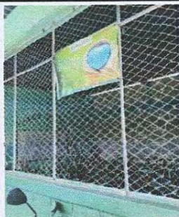
Foto 5: PODEMOS OBSERVAR QUE EN LA MAYORIA DE AULAS, LOS BALCONES COLOCADOS NO SON APTOS PARA LA SEGURIDAD DEL EDIFICIO
