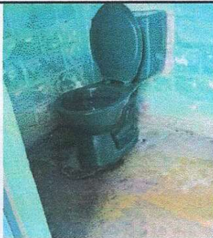
Foto 9: Podemos observar que el sanitario no funciona
