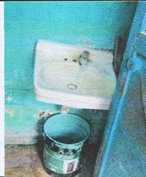
Foto 8: Podemos observar que el lavamanos esta en mal estado y quebrado
