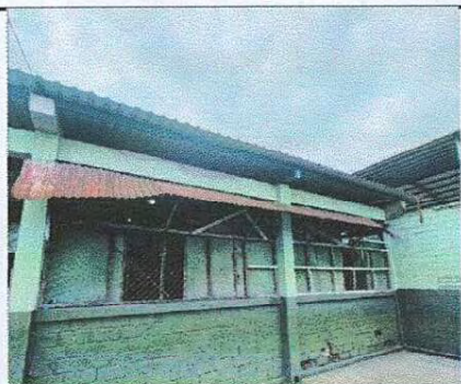
Foto 3: Podemos observar que los soportes de las laminas se encuentran deterioradas
