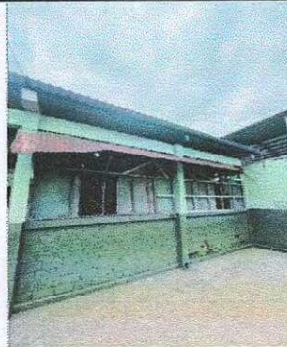
Foto 2: Podemos observar que las aulas seleccionadas cuentan con laminas tipo viseras en mal estado
