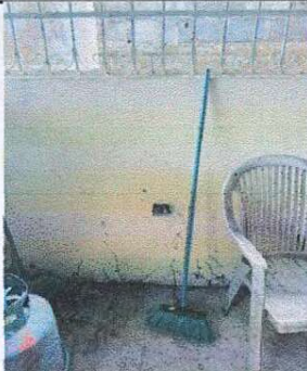
Foto 7: EN EL AREA DE COCINA NO SE CUENTA CON SUFICIENTES DISPOSITIVOS ELECTRONICOS
