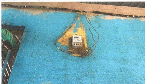
Foto 1: Se observa que el sistema eléctrico se encuentra en mal estado.
