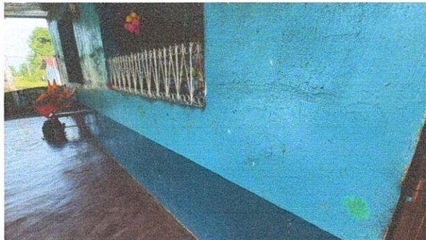
Foto 13: Se observa que la pintura se encuentra en mal estado.
