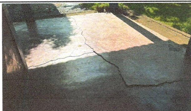
Foto 5: Se observa que el piso se encuentra en muy mal estado.
