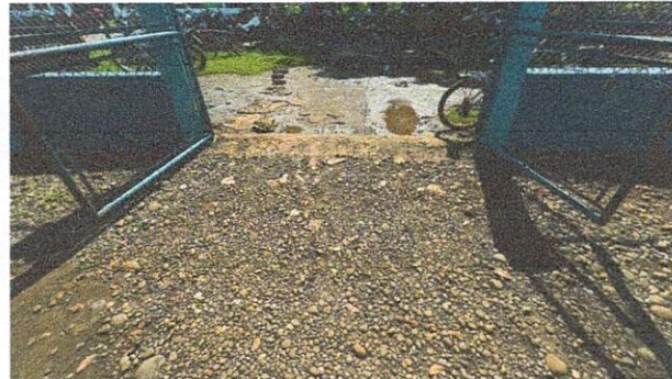
Foto 14: Se observa que es necesario agregar cunetas para mitigar el agua que entra a la escuela en época de lluvia.
