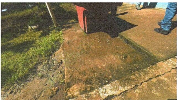
Foto 9: Se observa que no se cuenta con rampa para ingresar a aulas.
