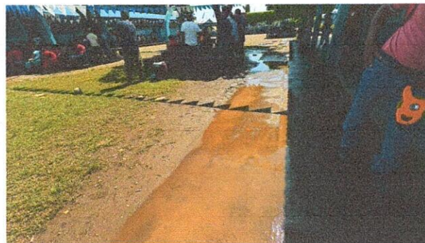
Foto 16: Se observa que se realizarán sumideros medianos para mitigar un poco el problema de el agua que inunda la escuela.
