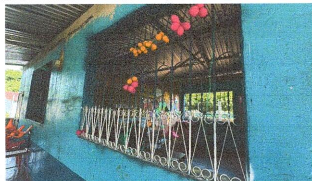
Foto 4: Se observa que los balcones requieren mantenimiento.
