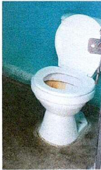
Foto 7: Se observa que los sanitarios ya requieren cambio.
