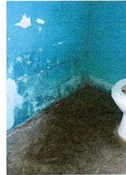
Foto 8: Se observa que la tubería de abasto de agua a los sanitarios y sistema de drenaje requieren sustitución, por ser un sistema demasiado antiguo.
