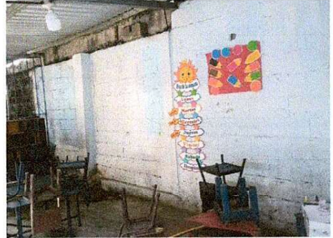
Foto 2: Se observa que los muros no cuentan con repello, en temporada de lluvia, estos se humedecen o se llenan de moho, se requiere repello y cernido.
