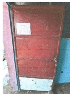
Foto 4: Se observa el estado de deterioro de la puerta.
