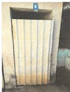
Foto 11: Se observa que los baños no cuentan con puertas fomaes.
