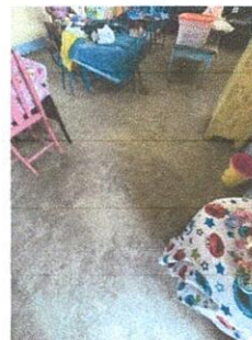
Foto 8: Se observa que no se cuenta con piso cerámico en aulas.
