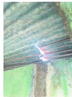
Foto 14: Se observa el mal estado de la cubierta de lámina en baños.
