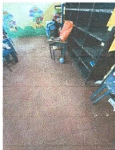
Foto 7: Se observa que el piso cerámico ya se encuentra en un estado de desgaste.
