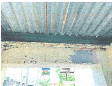
Foto 13: Se observa que el estado de la estructura metálica ya está desgastado por la corrosión
