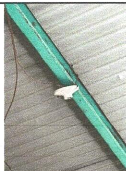
Foto 6: Se observa el sistema eléctrico en aulas sin funcionar.
