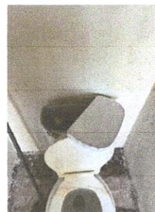
Foto 12: Se observa que el inodoro se encuentra sin uso.
