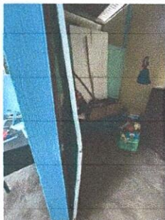
Foto 1: Se observa el estado del daño actual de la puerta.
