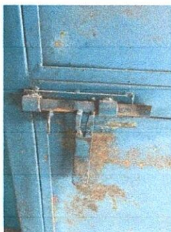
Foto 9: Se observa que se requiere chapa en puerta para seguridad de los insumos dentro de cocina.
