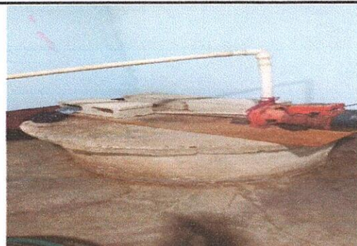
Foto 2: Pozo artesanal en malas condiciones.
