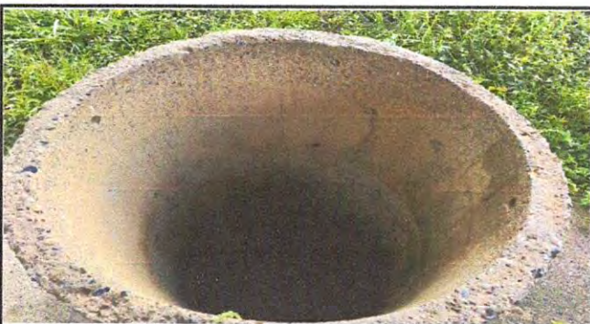
Foto 3: Boca del pozo que presenta un peligro para los niños al extraer agua manualmente.
