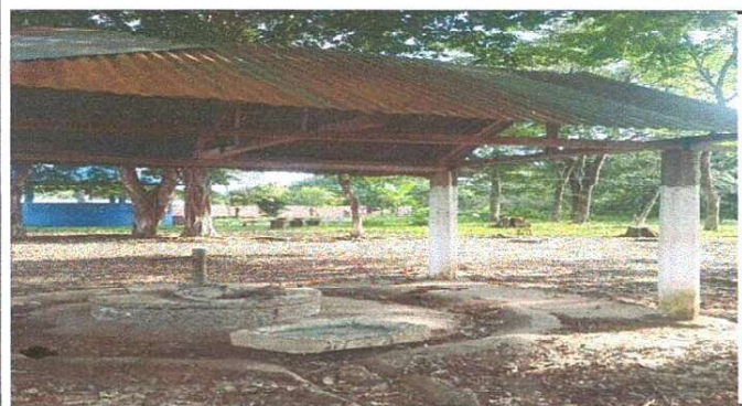
Foto 5: POZO SIN UTILIZACIÓN.
