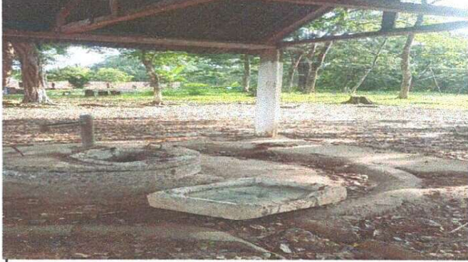
Foto 4: BOMBA MANUAL DEL POZO DESCOMPUESTA
