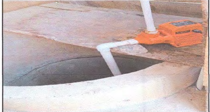
Foto 2: Pozo con respectiva bomba.
