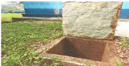
Foto 3: Pozo artesanal en estado inadecuado
