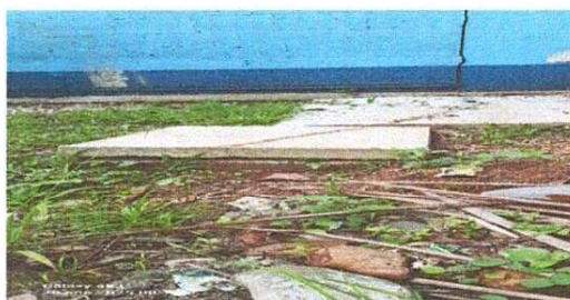
Foto 2: Estado actual de pozo artesanal
