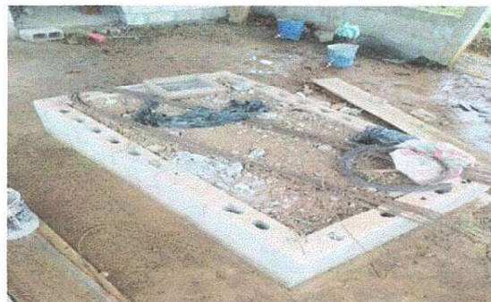
Foto 2: Piso en torta de cemento
