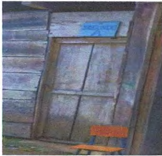
Foto 3: Sustrucción de puertas en mal estado.
