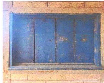
Foto 4: Sustrucción de ventanas de madera por balcones.
