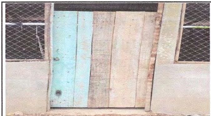
Foto 4: PUERTAS Y VENTANAS DE MADERA MUY ANTIGUAS.
