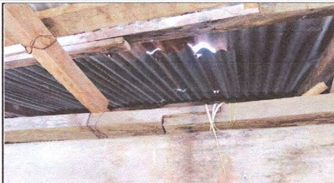
Foto 2: LAMINAS AGRIETADAS EN MUY MAL ESTADO.
