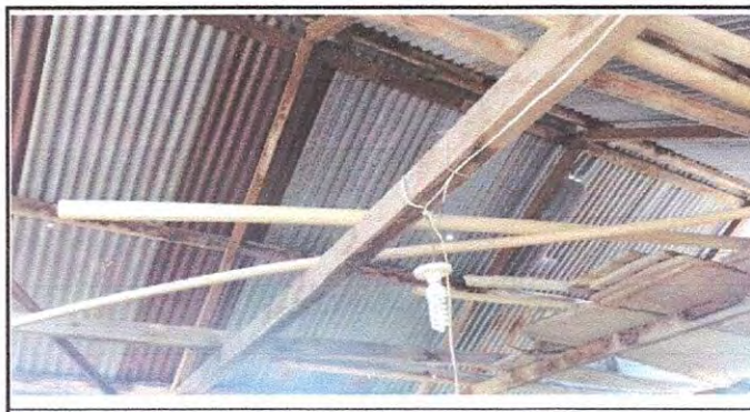
Foto 6: SISTEMA ELECTRICO EN MALAS CONDICIONES.
