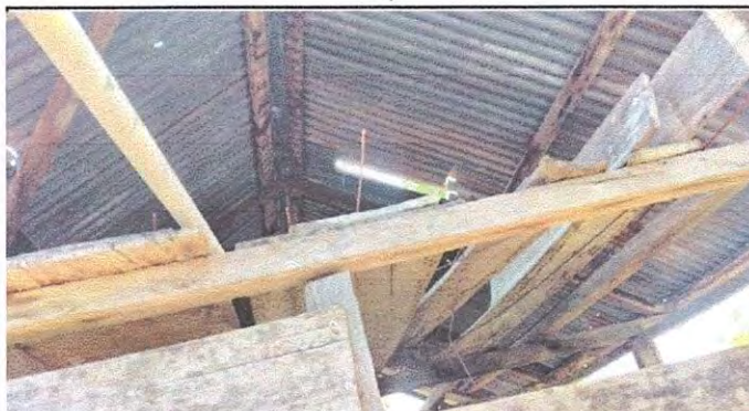
Foto 3: ESTRUCTURA DE MADERA EN MAL ESTADO.
