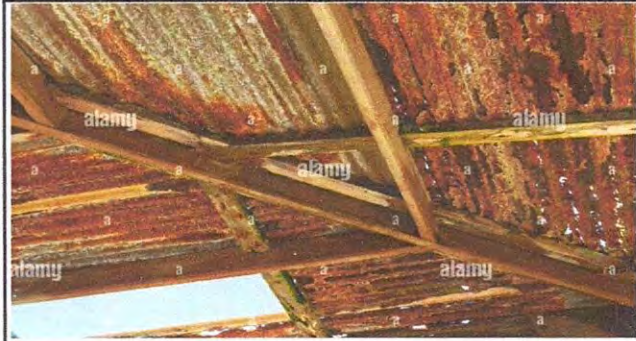
Foto 2: estructura de madera en malas condiciones.
