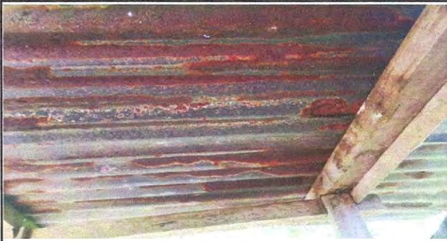
Foto 3: Lámina del corredor en mal estado.
