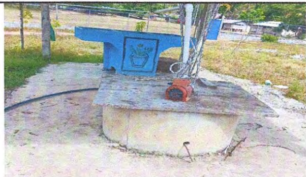
Foto 1: Pozo en malas condiciones. Debido a que en verano se queda sin agua.
