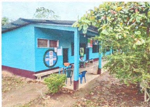
Foto 1: Modulo de tres aulas y direccion sin servicio de agua potable
