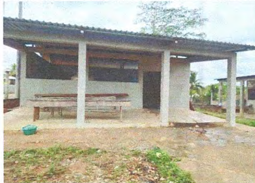
Foto 2: Modulo de cocina sin servicio de agua potable
