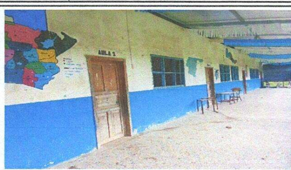
Foto 2: PISO DE CONCRETO EN AULAS Y CORREDOR EN MAL ESTADO.
