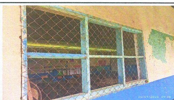
Foto 4: VENTANAS DE MADERA Y MAYA MUY DETERIORADAS.
