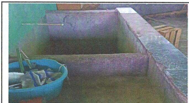
Foto 3: PILA DE COCINA EN MAL ESTADO Y FALTA DE TUBERÍA PRINCIPAL DE AGUA POTABLE.
