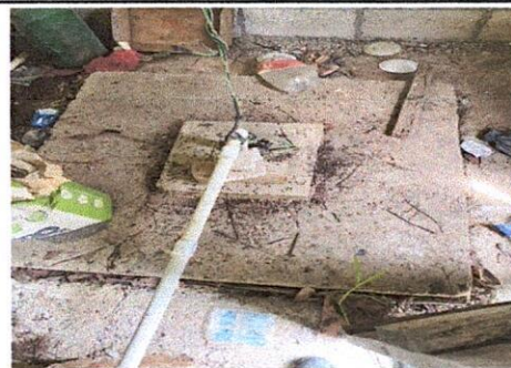
Foto 6: Tapa del pozo
