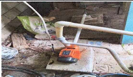
Foto 4: Red de distribución de agua
