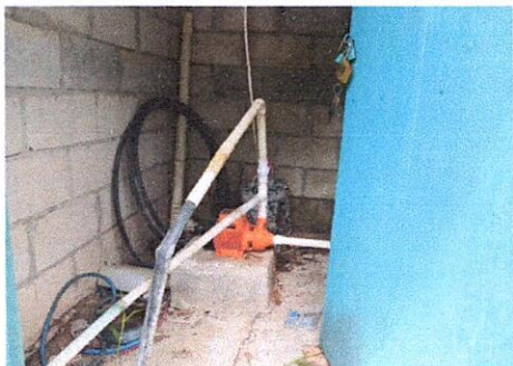
Foto 1: Bomba actual del pozo
