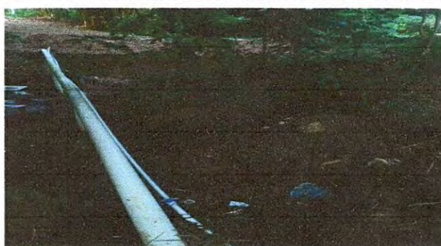
Foto 4: tubería en mal estado
