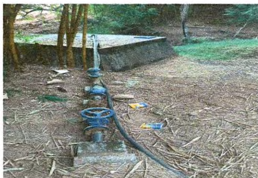
Foto 3: llave de paso oxidado
