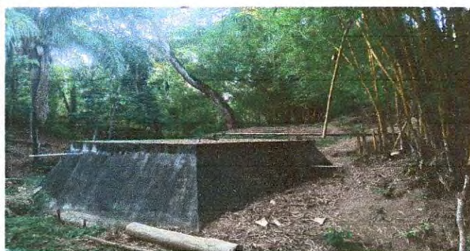
Foto 2: tanque de captacion de agua con grietas
