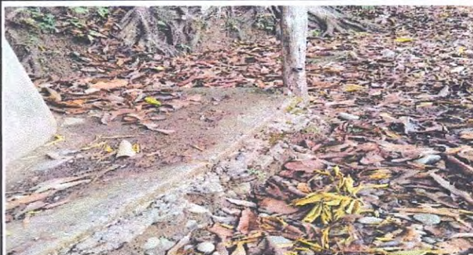
Foto 2: tanque de captacion de agua con grietas
