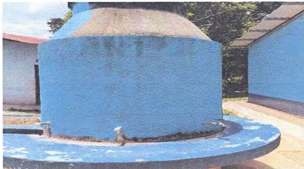
Foto1: Tanque de distribución de agua en mal estado
