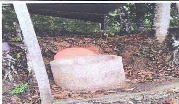
Foto 4: Estructura en mal estado
