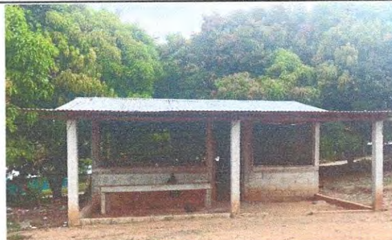
Foto 2: VISTA NORTE DE LA COCINA CON NECESIDAD DE AGUA PARA PREPARAR LOS ALIMENTOS.
