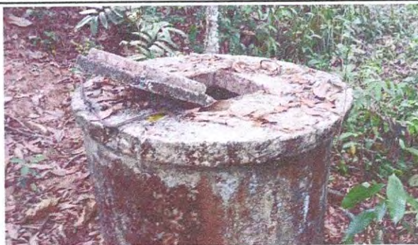
Foto 4: NECESIDAD DE NUEVA TUBERÍA PRINCIPAL Y SUS ACCESORIOS.
