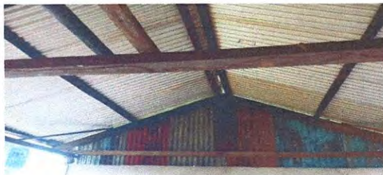
Foto 2: ESTADO ACTUAL DE LA MADERA DE LA COCINA
