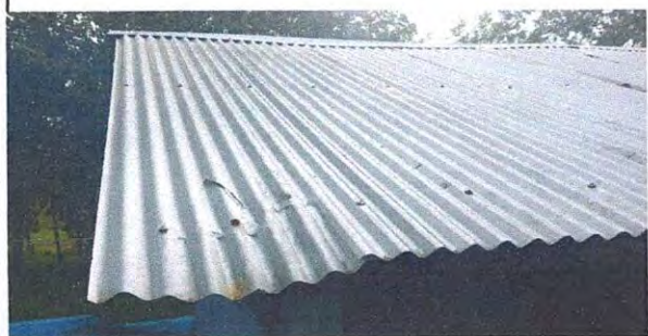
Foto 3: LAMINA EN MAL ESTADO DE LA COCINA ACTUAL
