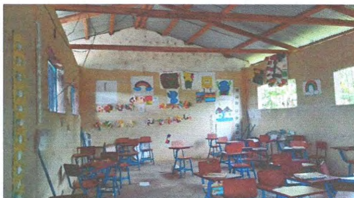
Foto 4: Cambio de color de pintura dentro del aula.
