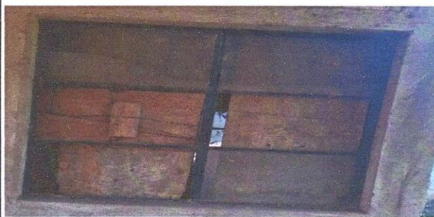
Foto 4: Sustrucción de ventanas de madera por balcones.
