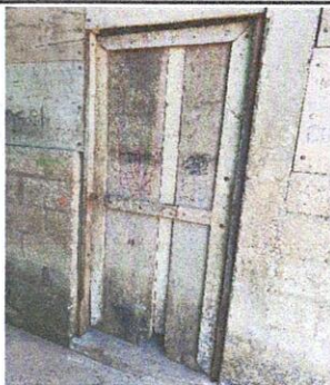
Foto1: Puerta en mal estado
