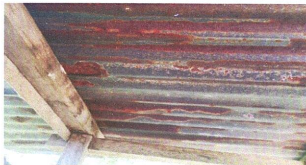
Foto 4: Laminas en mal estado
