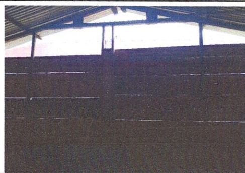
Foto 6: Estructura en mal estado
