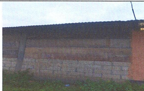
Foto 2: Parte de atrás en mal estado
