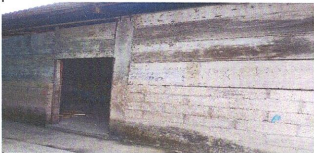
Foto 3: Parte enfrente en mal estado
