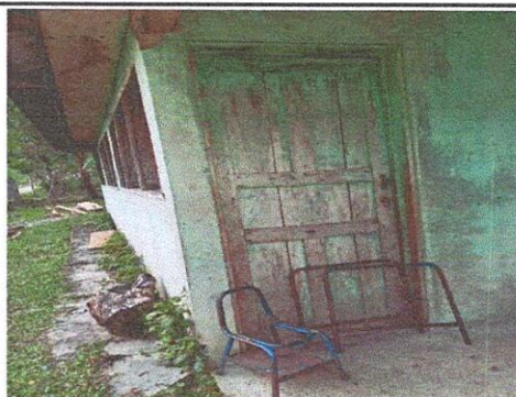
Foto 5: puerta deteriorada por el reflejo del sol y lluvia.
