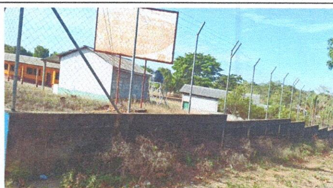
Foto 2: VISTA DEL MÓDULO DE MURO PERIMETRAL SIN REPELLAR EL CUAL LLEVA AÑOS SIN DARLE MANTENIMIENTO.
