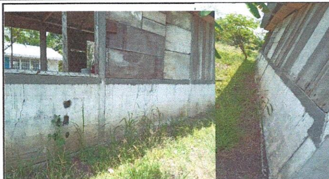
Foto1: Vista del parte exterior de paredes que necesitan repello
