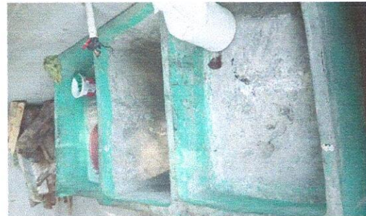
Foto 10: La pila esta agrietada necesita cambio, ademas se necesita cambio de un chorro e instalacion de una mas.
