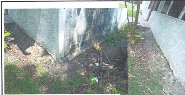
Foto 4: se necesita banquetas alrededor del perimetro de la cocina y sustitucion de cunetas.
