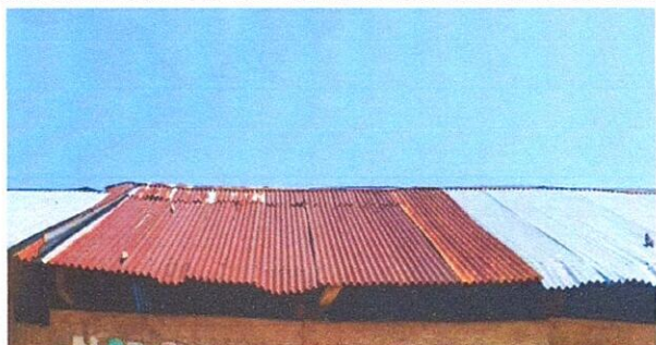
Foto1: VISTA GENERAL DE LAMINAS EN MAL ESTADO.
