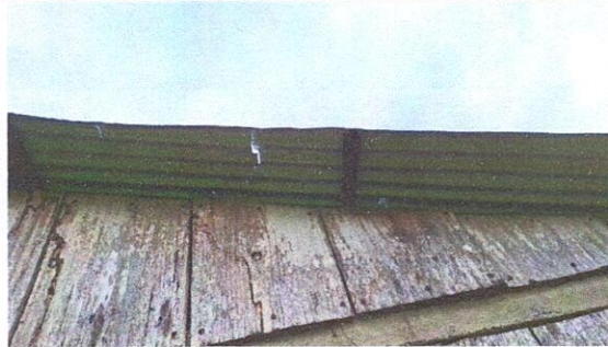
Foto 2: VISTA DE LAMINAS ROTAS Y PAREDES EN MAL ESTADO.
