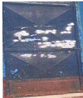
Foto 6: PUERTA DE METAL EN MALAS CONDICIONES
