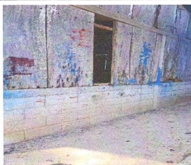
Foto 5: PAREDES EN MALAS CONDICIONES
