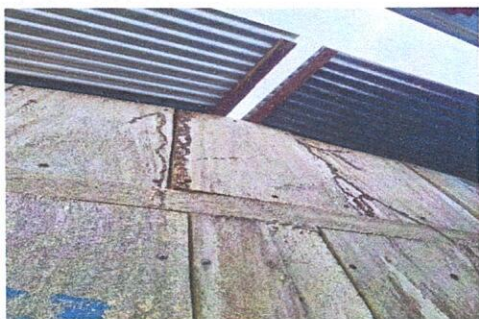
Foto 3: ESTRUCTURA DE MADERA EN MAL ESTADO
