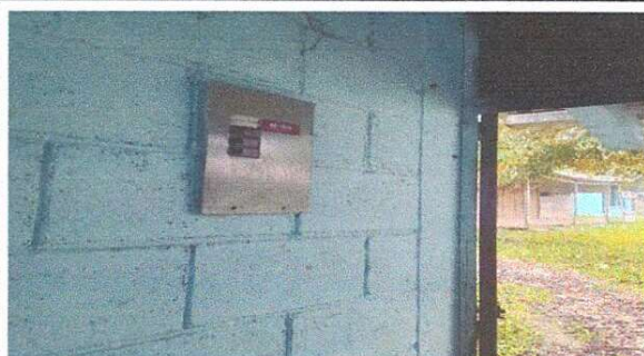
Foto 4: El establecimiento cuenta con instalación de energía eléctrica.
