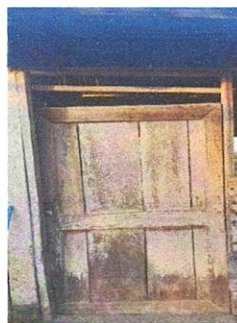
Foto 4: Frente y puertas de madera muy deteriorado
