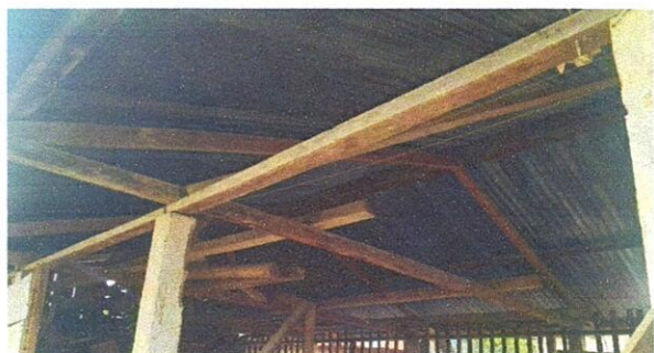
Foto 3: Estructura de madera en mal estado
