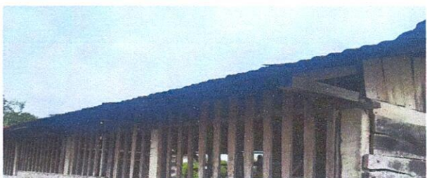
Foto 5: Ventanas de madera en mal estado
