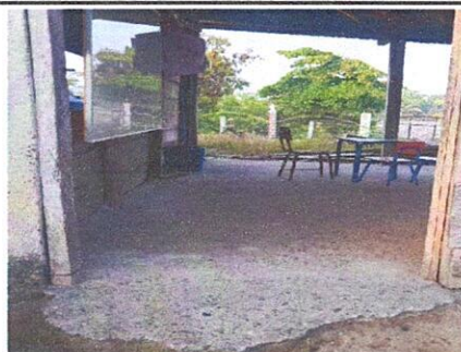
Foto 6: Establecimiento piso del muy agrietado
