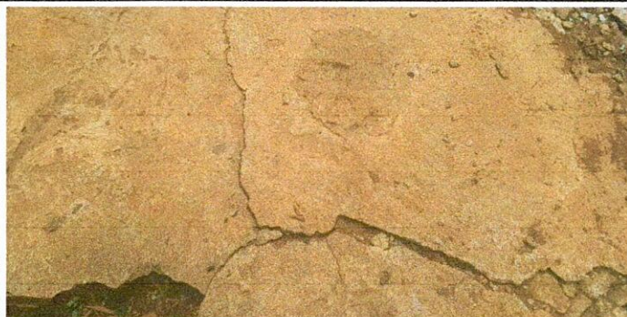
Foto1: Sustrucción de torta de concreto
