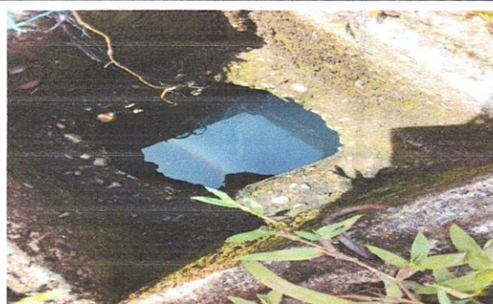
Foto 4: VISTA INTERNA DEL POZO ARTESANAL.
