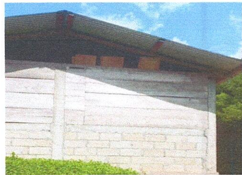
Foto 4: PARED DE COCINA ESCOLAR ACTUAL
