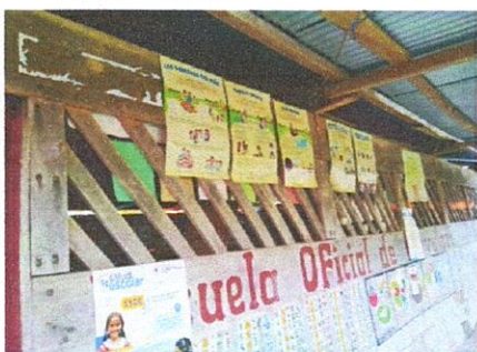
Foto 5: VENTANAS DE MADERA EN MAL ESTADO.
