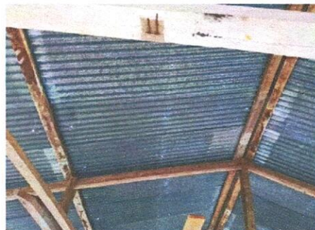
Foto 4: BIGAS DE MADERA DE LA COCINA DETERIORADA.
