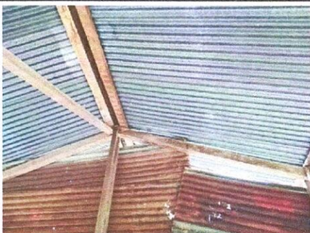
Foto 3: LAMINA DE LA COCINA DETERIORADA.
