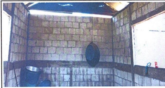
Foto 6: INTERIOR DEL MÓDULO DE COCINA. SE REQUIERE REPELLO TOTAL DEL INTERIOR DE LA COCINA.
