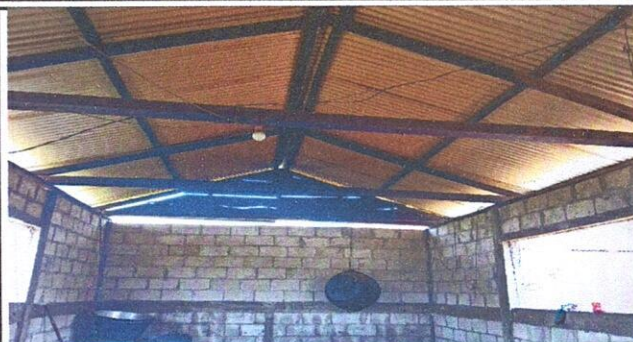
Foto 2: INTERIOR DEL MÓDULO DE COCINA: SE OBSERVA LA ESTRUCTURA DE SOPORTE DE MADERA EL CUAL SE SOLICITA LA SUSTITUCION POR SOPORTE DE METAL.
