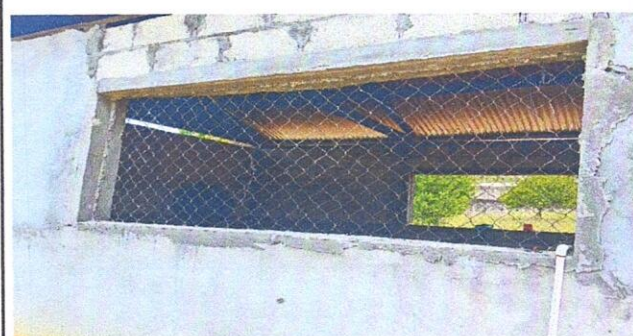
Foto 4: BALCÓN EN MÓDULO DE COCINA, ACTUALMENTE ESTA CERRADO CON MALLA IMPROVISADA, POR LO QUE REQUIERE SER SUSTITUIDO POR BALCONES DE HIERRO EN VENTANA
