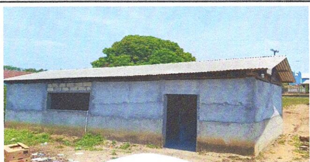
Foto 1: IMAGEN DEL MÓDULO DE COCINA: EN EL QUE SE REQUIERE SUSTITUCIÓN DE LÁMINA POR LÁMINA TROQUELADA ALUZINC CALIBRE 26, CON CAPOTE PARA LÁMINA TROQUELADA DEBIDO A QUE EL TECHO ESTA MUY BAJO Y SE ENCIERRA EL HUMO
