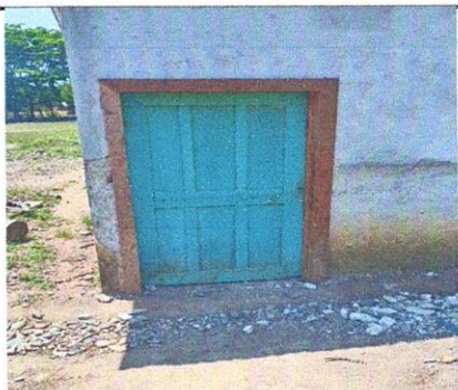
Foto 3: PUERTA DE MÓDULO DE COCINA, ACTUALMENTE CUENTA CON UNA PUERTA DE MADERA, REQUIERE SER SUSTITUDA POR UNA PUERTA MÁS FORMAL
