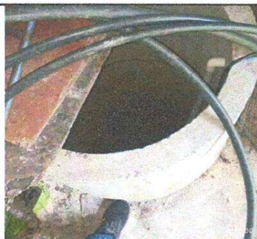
Foto 4: NECESIDAD DE NUEVA TUBERÍA PRINCIPAL Y SUS ACCESORIOS.
