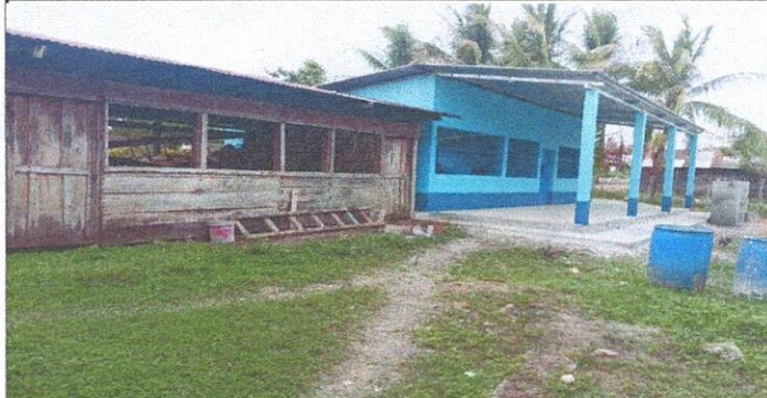
Foto 2: vista de la cocina con necesidad de agua para reparar.
