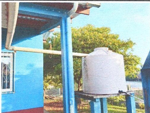
Foto 3: Red de captación de agua pluvial.
