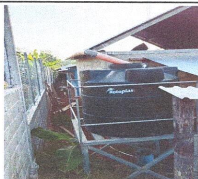
Foto 4: Depósito de agua elevado cocina.
