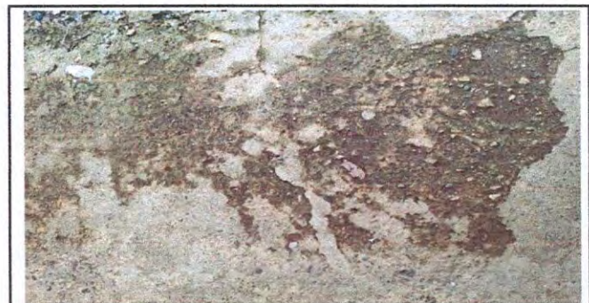
Foto 6: PISO DE LA COCINA ESCOLAR MUY AGRIETADO. RENGLO 5.1.
