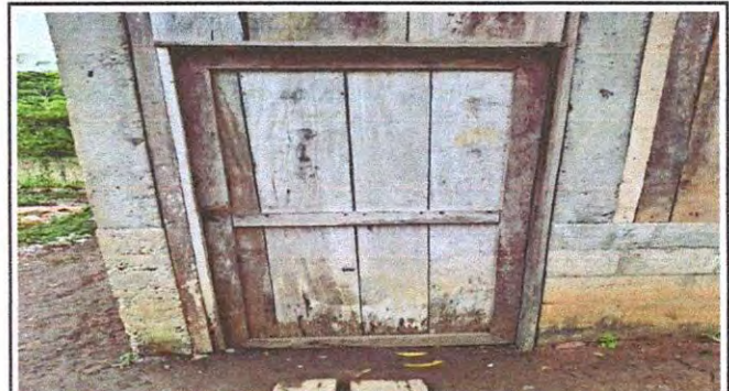
Foto 4: PUERTA DE MADERA EN MUY MAL ESTADO. RENGLO 3. 1.
