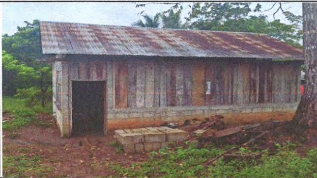
Foto1: VISTA GENERAL DE LA COCINA ESCOLAR CON INFRAESTRUCTURA EN MAL ESTADO. RENGLO 1. 1.
