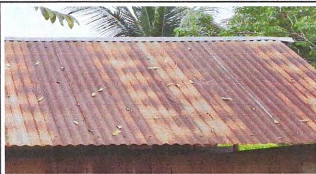
Foto 3: LÁMINAS DE LA COCINA ESCOLAR MUY DETERIORADA. RENGLO 1.2.
