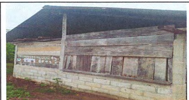
Foto 5: VENTANAS DE MADERA MUY ANTIGUAS. RENGLO 4. 1.
