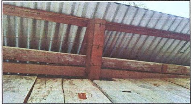
Foto 2: ESTRUCTURA DE MADERA EN MAL ESTADO. RENGLO 2. 1.
