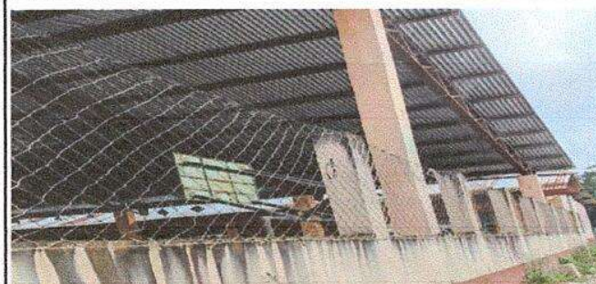
Foto 6: Sustrucción de malla por baranda de metal
