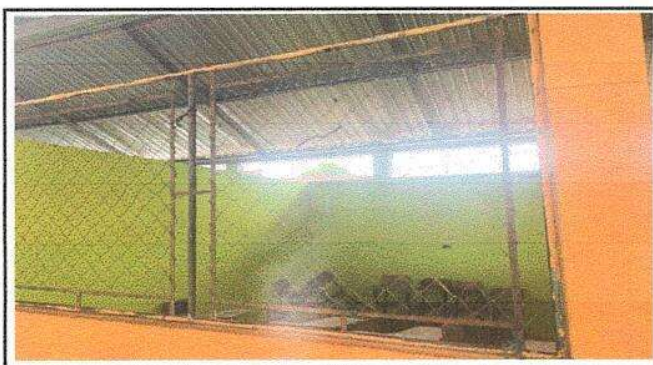
Foto 4: Sustrucción de balcones de malla por metal
