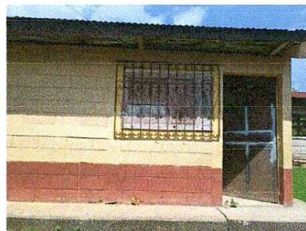
Foto 4: Vista lateral de las cocina en pesimas condiciones.
