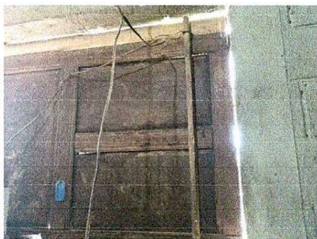
Foto 3: Ventana de madera de la cocina en mal estado.
