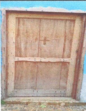
Foto 3: PUERTA DE MADERA EN MAL ESTADO
