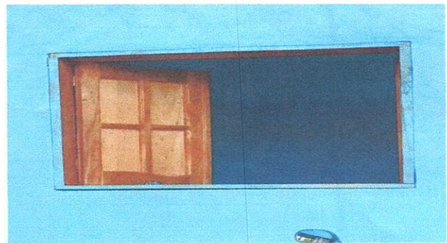
Foto4: VENTANA DE MADERA EN MAL ESTADO.
