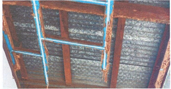
Foto 2: ESTRUCTURA DE MADERA PARA TECHO CON RIESGO DE CAERSE.
