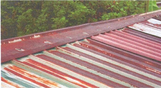
Foto1: LÁMINAS CON OXIDOS, DETERIORADAS, EN INVIERNO SE FILTRA LA LLUVIA POR ANTIGÜEDAD DE LAS LÁMINAS.
