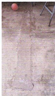
Foto 3: piso con desnivel y agrietado
