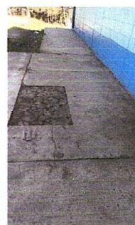
Foto 4: piso del corredor en mal estado
