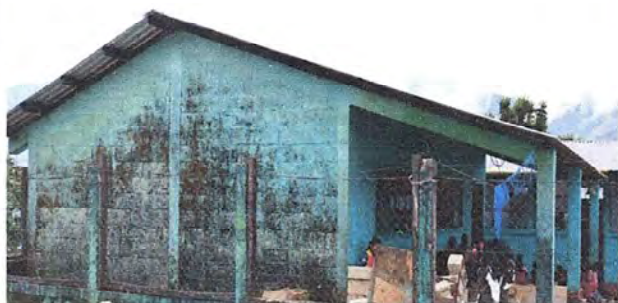
Foto 7: Módulo 4. Pintura en muros exteriores.
