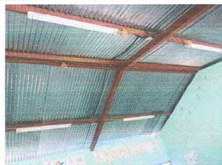
Foto 4: modulo 1 sustitucion de lámparas de 2x40
