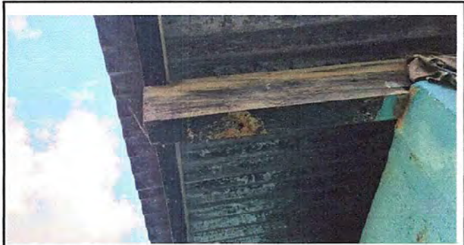
Foto 2: Modulo 1: Situación de soporte de madera a metal
