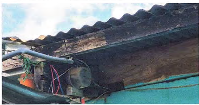
Foto 3: Modulo 1: Situación de soporte de madera a metal
