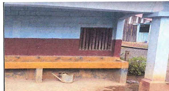
Foto 6: Cocina: Sustitución de ventana de madera por metal mas vidrio
